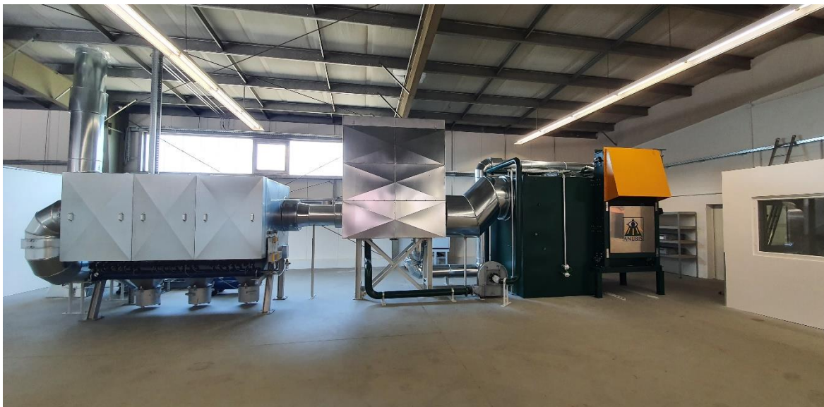
Der Kremierungsofen steht in einem hygienisch sauberen Raum. Haustiere jeglicher Art können hier kremiert werden. Im Bild: Tierkrematorium Calbe.
